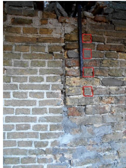
50. In de noordgevel bevindt zich ter hoogte van de oostelijke kademuur een vertanding.
