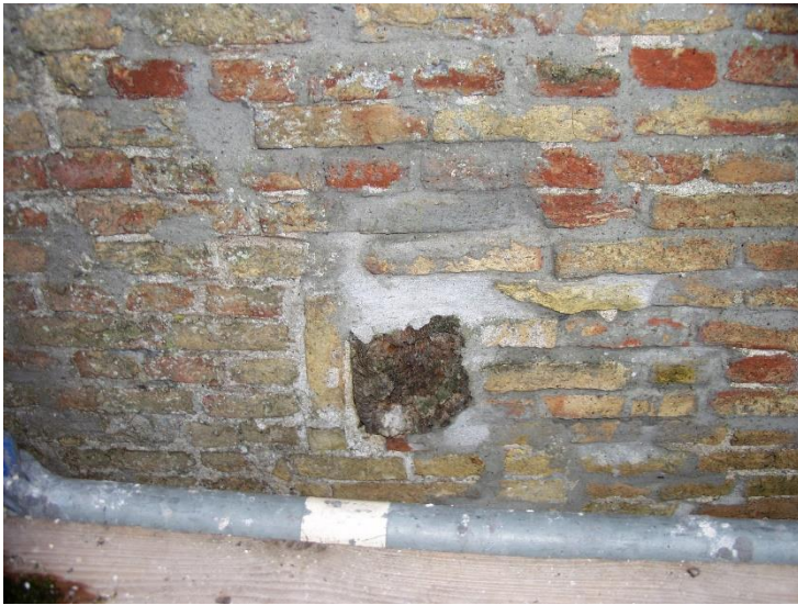
15. In de noordgevel zijn alle balkkoppen van het achterliggende balkon zichtbaar. Het aangepaste metselwerk rondom maakt duidelijk dat er aan de plaatsing van de balken in de gevel gemorreld is.
