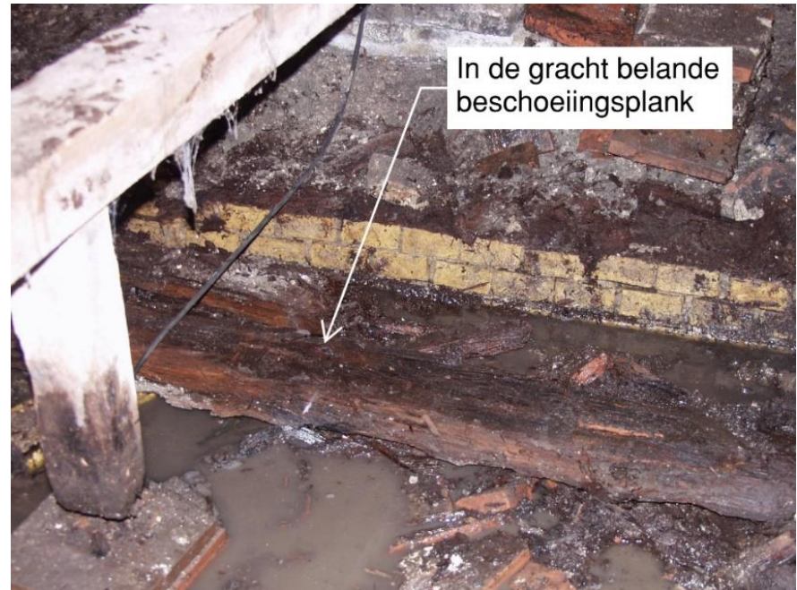
41 – 42. De kademuur aan de westkant was afgezet met een randje plavuizen, die aan de oostkant met een houten boeiplank.
